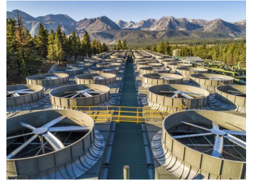
Casa Diablo Geothermal
