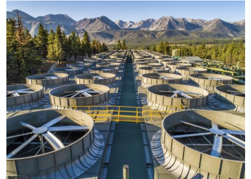
Casa Diablo Geothermal
