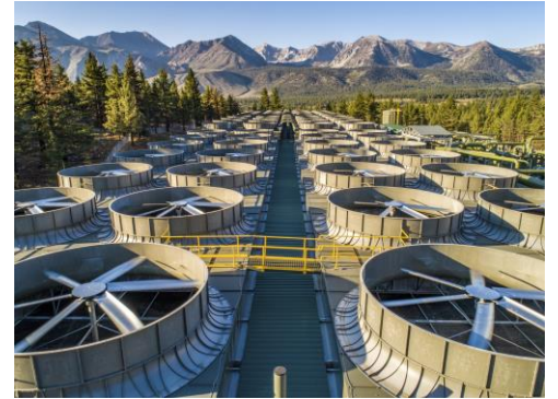
Casa Diablo Geothermal
