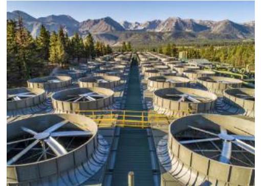
Casa Diablo Geothermal
