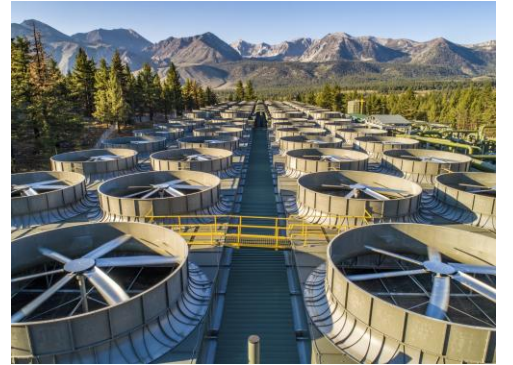
Casa Diablo Geothermal
