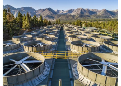
Casa Diablo Geothermal
